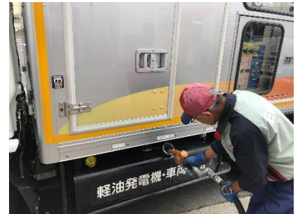
北海道停電で北海道北見市の組合員SSは、北海道電力の移動電源車に軽油ローリーから給油を続けた
