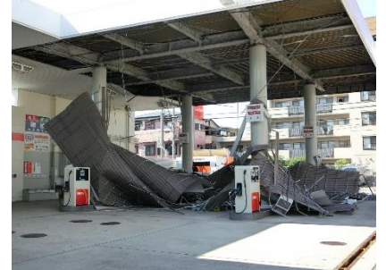
9月5日の台風21号災害では、近畿地区のSSに大きな被害が発生した。写真は大阪・豊中市のSS
